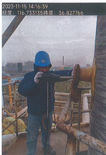
对甲酚硫酸排气筒(DA040)
